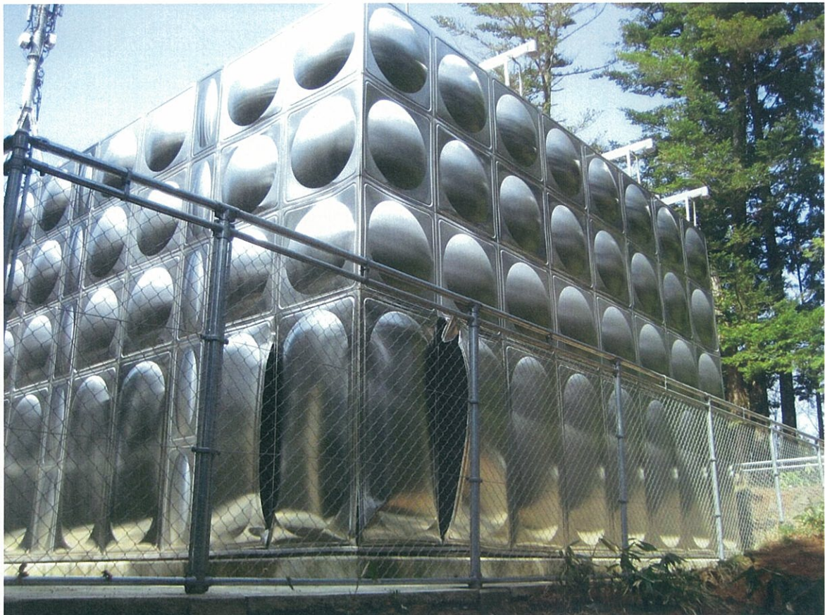
写真 5.4 長沢配水池の被害状況 (1)
