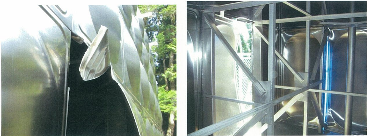
写真 5.5 長沢配水池の被害状況 (2)
