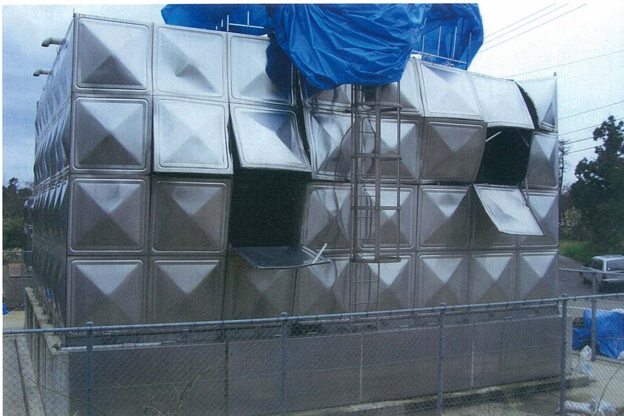
写真 5.1 剣地配水池の被害状況 (1)
