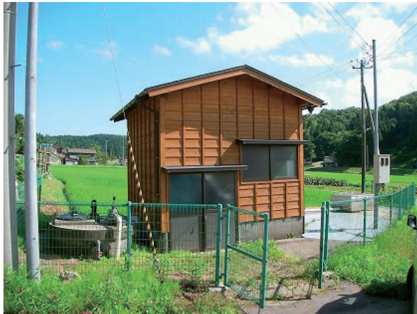
写真 5.11 神条1号ポンプ場液状化による建屋の傾斜状況
