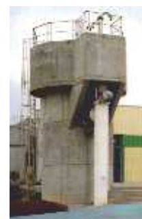
Uチューブオゾン接触装置
