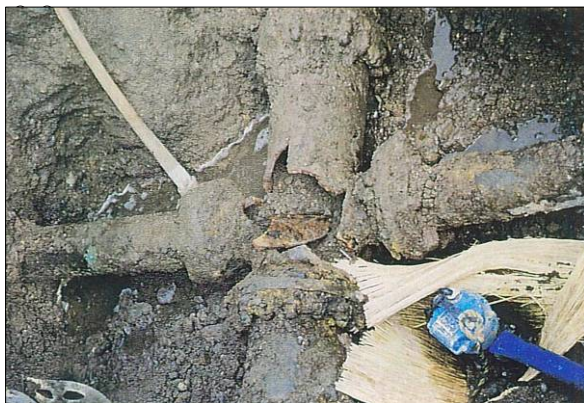
a) φ250×φ150 十字管 鋳鉄管 折損
