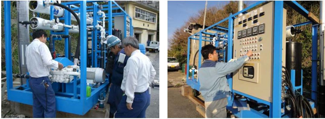
写真 4.1 可搬式海水淡水化装置運転状況
