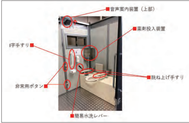
「Hi!トイレ」の内部設備
