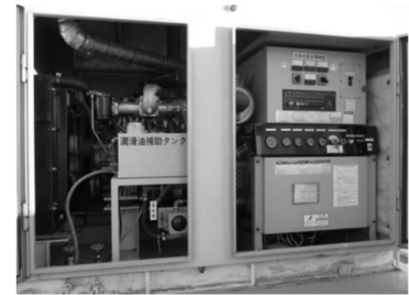
<自家発電設備>
