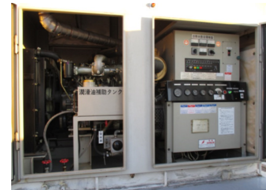
<自家発電設備>
