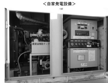
<自家発電設備>
