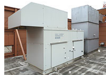
（非常用自家発電装置）
