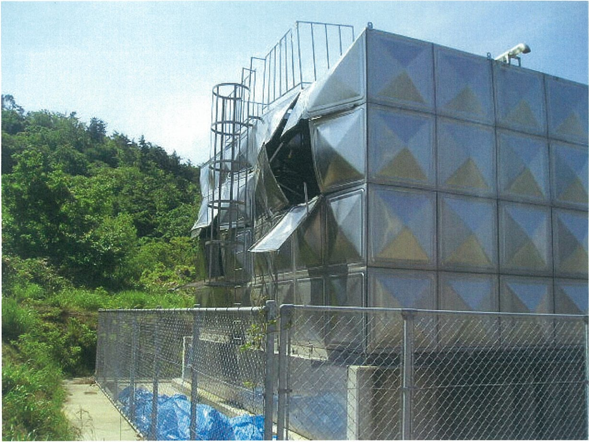
写真 5.2 剣地配水池の被害状況 (2)
