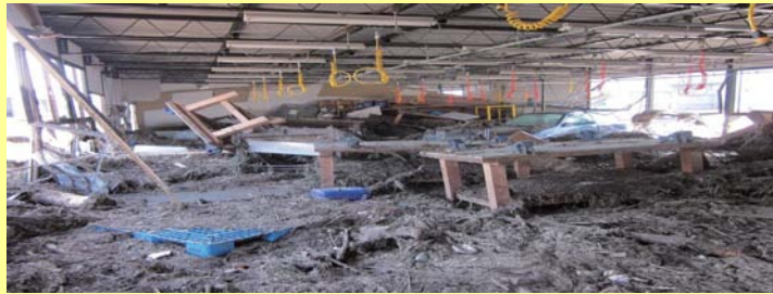
●津波により破壊された実習室
