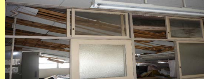
●地震により天井が崩落した教室
