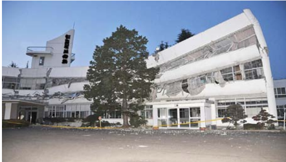
●地震により倒壊した校舎
