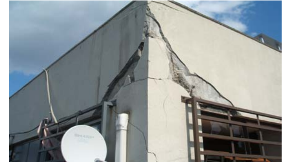
●外壁が剥がれ落ちた校舎
