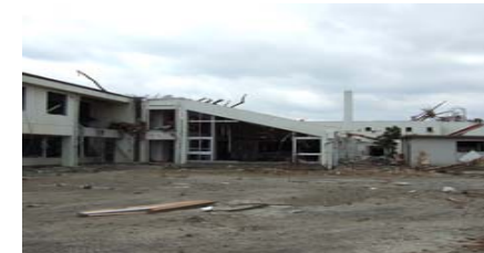
○津波により松の木が屋上にまで流入した自然の家 (福島県)
