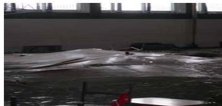
○津波によりフロアが歪曲した体育館 (宮城県)
