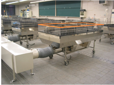
局所排気装置の各実習台への設置
