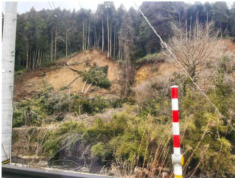
山肌の土砂崩れ
