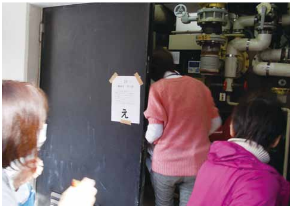
写真6 平面図をもとにチェックポイントを発見。機械室の消火器を調べる
