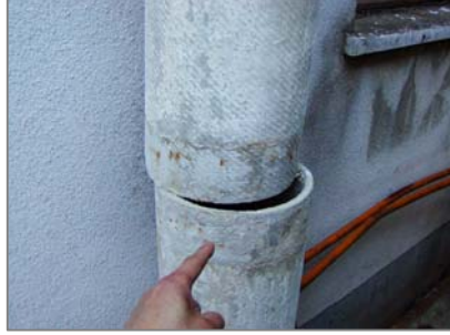
雨水樋使用石綿パイプ
