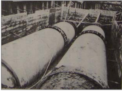
大口径水道管
