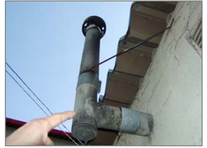
暖房排熱用石綿パイプ
