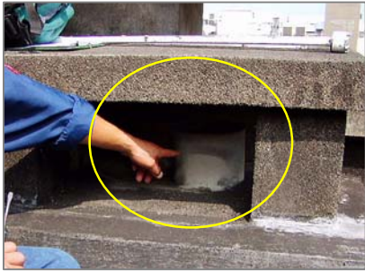
学校屋上の石綿パイプ(煙突用)
