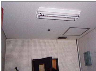
天井/石綿含有吸音板、 壁/石綿含有けい酸カルシウム有穴板
