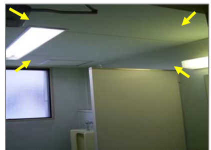
フレキシブル板 トイレの天井
