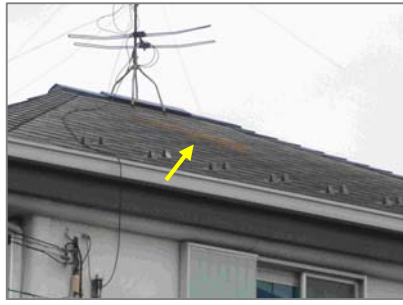
屋根材の塗料のはげ
