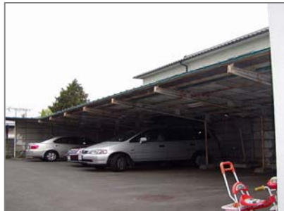
駐車場屋根裏(一方向開放型の駐車場。屋根裏に石綿フェルトが張られています。)
