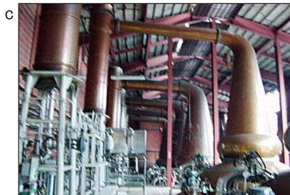
洋酒工場の蒸留装置。寒冷地にあるため建物の結露防止で吹きつけ石綿が施工されています。装置内に石綿粉じんが入ることはありませんが、吹きつけ石綿の劣化や損傷により、作業員が石綿粉じんにはく露する可能性があります。
