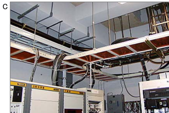
C 放送局の通信機械室の天井。殆どのTV・ラジオ局の収録スタジオ・調音室・ミキサー室・編集室の壁、天井には石綿穴あき板が吸音のために使用されています。劣化や破損により、放送関係者のばく露の可能性があります。
