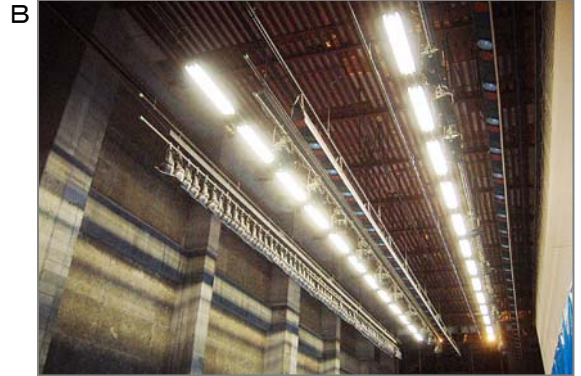
B 舞台の袖から天井を見上げた写真。照明ライトやスクリーンを吊っている上はブドウ棚があり、殆どのホールで吹きつけ施工されてます。奥、両袖の壁および奈落部も同様です。吹きつけの劣化や損傷により、舞台関係者がばく露する可能性があります。
