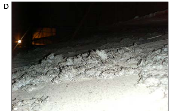
D 劇場の客席の天井裏およびキャットウォーク、シーリングスポット、ピンスポット室などに吹きつけ石綿があります。写真は劇場の天井裏に石綿が脱落しているところ。
