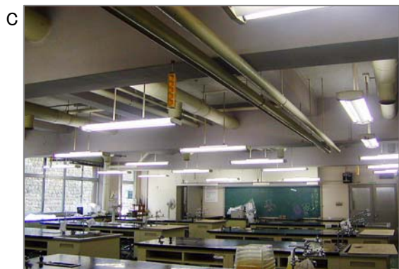
C 学校の実験室の天井に吹きつけ石綿があります。バーナーやアルコールランプなど火を使うため、耐火・結露防止目的と考えられます。一部、大きく脱落している箇所があり、露出した破損部から飛散した石綿に、教員が長期にわたってばく露した可能性があります。
