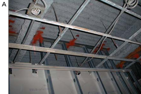
A 吹きつけ石綿のある建物の工事例で電気・衛生・建築業者が作業しました。吹きつけ石綿が除去され赤い鉄骨が見えますが、作業をした際に石綿にばく露した可能性があります。
