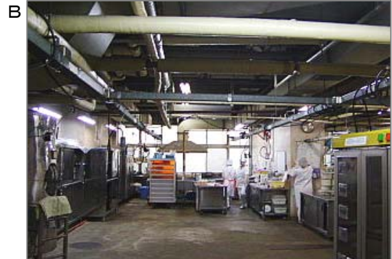
B 大病院の厨房。厨房は火を使う場所ですので、防火や結露防止の目的で石綿の吹きつけがされていることが多いです。ここは、天井に石綿が吹きつけられています。
