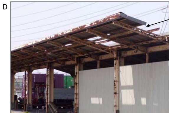
D 長く放置された貨車専用のプラットフォーム。スレート屋根は人為的な破壊を伴わなくても経年劣化で強度が弱り、ヒョウや積雪で破れ、破損部から石綿が飛散することがあります。
