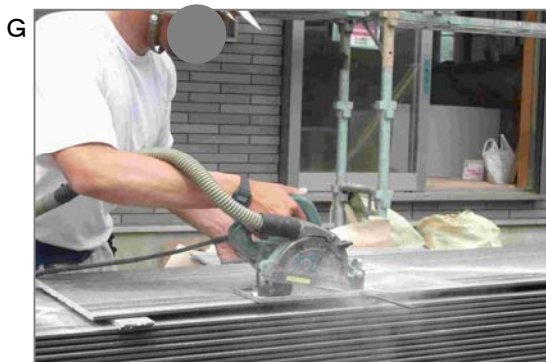
G 住宅の外壁サイディング張り工事。大工、屋根工、板金工なども施工します。屋外での現場合わせの切断ですから風向きによっては粉じんが遠くまで飛びます。粉じん発生量は非常に多いです。
