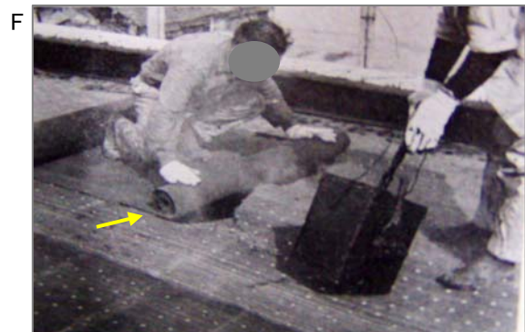
②昭和30年代の屋根の防水工事。アスファルトフェルト(巻物)を押し広げ、重なり部分に解かしたアスファルト(増粘剤として石綿を混ぜることあり)を流し込みます。非常に“熱い作業”なので石綿製の手袋等を使用することもありました。
