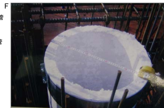
F 煙突ライニング材。写真はノンアス品。従前は茶石綿の高含有品を使用。多くのビルで採用していました。煙突内の上昇気流(ドラフト)で若干、繊維が大気に放出され作業員がばく露する可能性があります。
