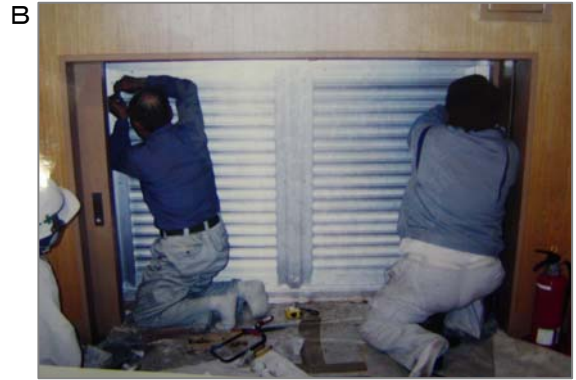
B サッシ工事(金属建具工事)。写真では判りづらいのですが内壁などに吹つけられている石綿を少し掻きとって鉄骨面から補強のリブ(カ骨)などを入れる箇所があります。
