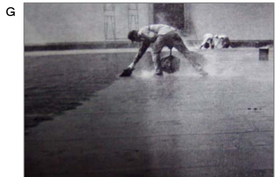
③最後のタールを上塗りしているところ。打ち粉として微小な石綿をふっていたかもしれませんが確認できていません。このあとの時代は、石綿とは関連のないシート防水が主流になりました。
