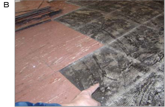
床の石綿含有ビニル床タイルは重歩行度や温湿度、経年などで劣化(剥れ、浮き、磨耗など)します。この黒い接着剤にも石綿は混入しています。張替えはこの接着剤をキレイにサンダー掛しますが、その際に石綿にばく露する可能性があります。
