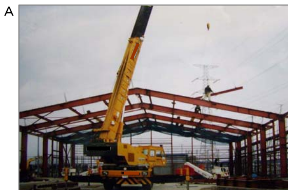
A 鉄骨で建物の骨格を作ります(鉄骨工事・とび職)。建物の仕様・要求によりこの柱や梁に後から耐火被覆(石綿の吹きつけ)を施工します。
