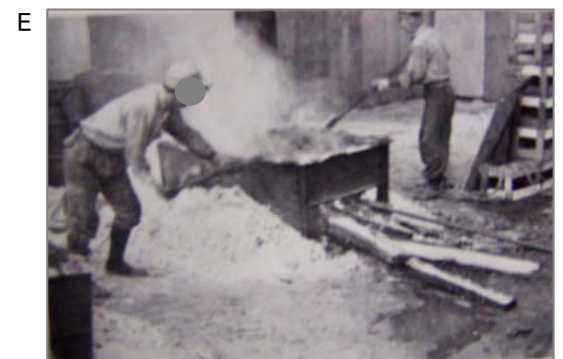
①昭和30年代のアスファルト工事(昭和60年頃まで)。アスファルト(石炭副産物・コールタール)の塊をフネ(鉄板の桶)に入れ、下から溶けるまで熱します。アスファルトに石綿を混ぜた時期があったようです。①から③の順で作業が行われます。
