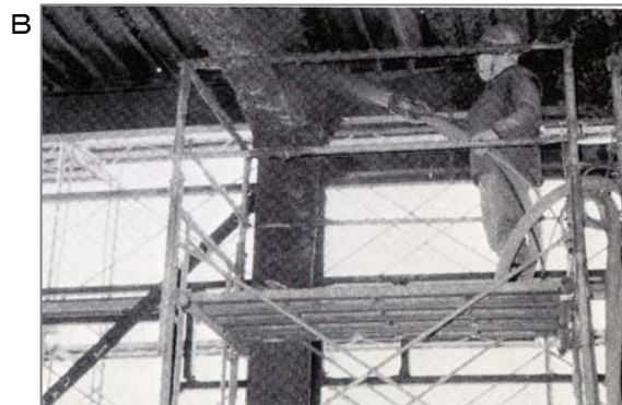
B 鉄骨建て方・床・屋根が出来ると耐火工事が始まります。吹きつけ機を用いて石綿の吹きつけがおこなわれていました。
