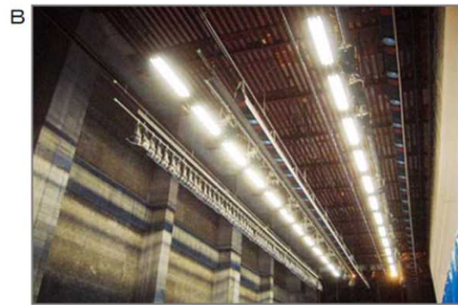
B 舞台の袖から天井を見上げた写真。照明ライトやスクリーンを吊っている上はドウ棚があり、殆どのホールで吹きつけ施工されています。奥、両袖の壁および奈落部も同様です。吹きつけの劣化や損傷により、舞台関係者がばく露する可能性があります。
