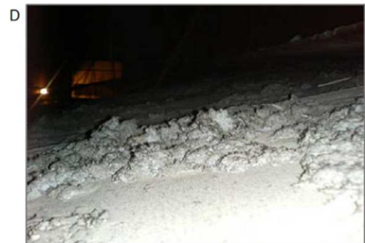
D 劇場の客席の天井裏およびキャットウォーク、シーリングスポット、ピンスポット室などに吹きつけ石綿があります。写真は劇場の天井裏に石綿が脱落しているところ。
