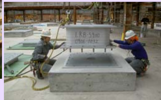
免震装置のセット状況
