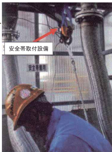
図 4-30 タンクローリー上部の建屋内に設置された安全带取付設備
