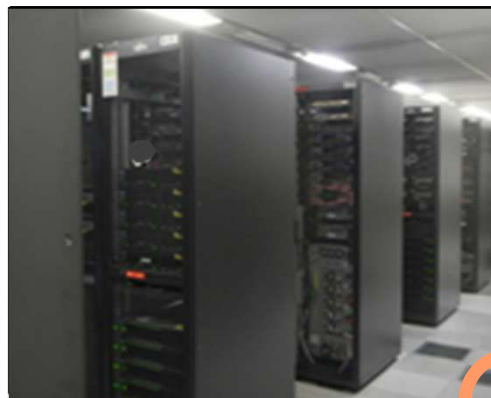
サーバールーム
