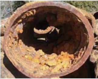
[ 水道管の経年化による内面腐食 ]
