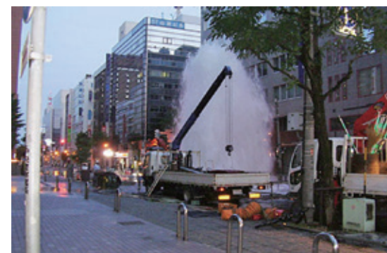
【街中での漏水事故】
