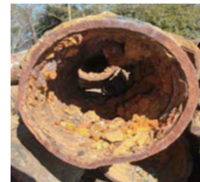
【水道管の経年化による内面浸食】
