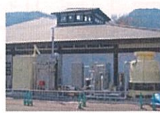
冷暖房用ボイラ （勝山木材ふれあい会館）
