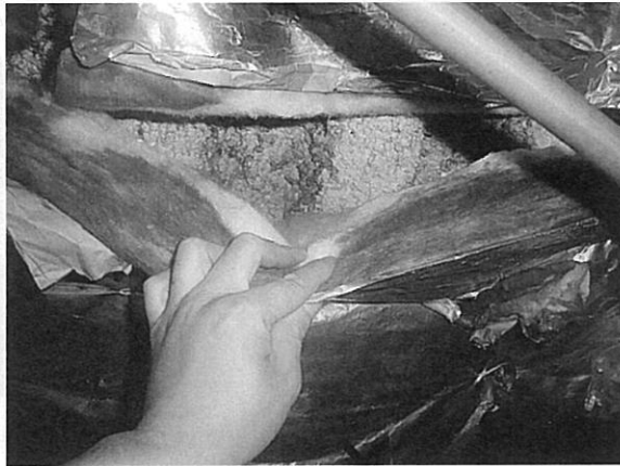
商業ビル グラスウール断熱材の裏の吹付け材 意図的囲い込み 見落としやすい 内装仕上げ材の下に吹付け材が存在する例-4
