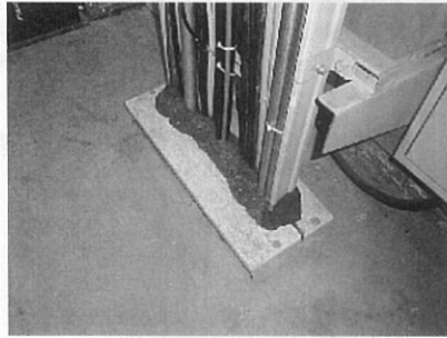
ケーブル床貫通部
