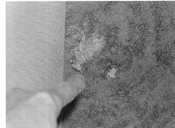
商業ビル機械室 左のガラスクロス下の吹付け材 青石綿 クロスの裏。見えないことも有る
