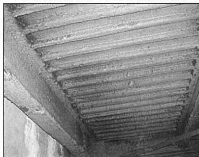
石綿含有吹付け材
