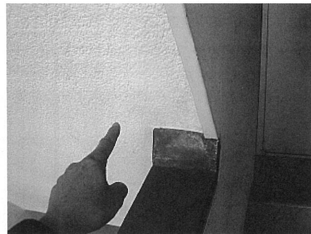
階段、吹付けバーミキュライトに複数回の塗装仕上げ 内外装仕上げ材の下にレベル1建材が存在する例-2
