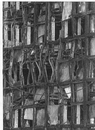
9階西面の耐火被覆の無いS造柱(撮影:宮本圭一(調査団)) 出典:マドリード市ウインザービル火災調査報告書
