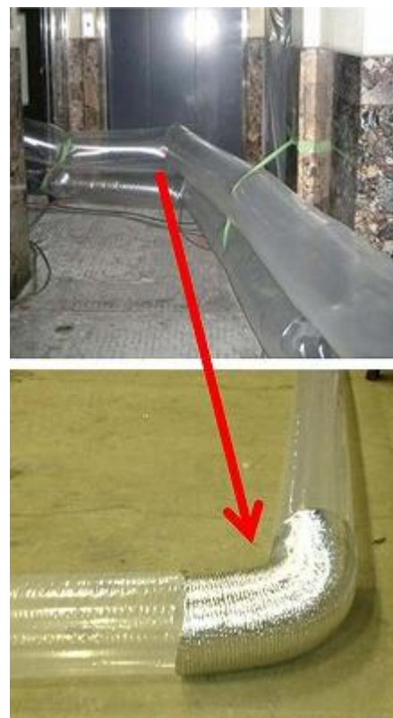
図－19 ビニールダクトの曲がり部分に環状の支え（アルミ製ダクト）をビニールダクトに重ねて使用した例
