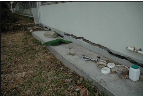
○日製日立総合病院（日立市） 土台への亀裂等複数病棟の使用停止、MRI等医療機器が損傷
