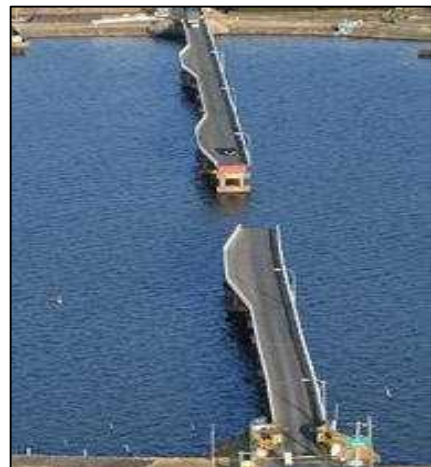
橋桁の中央部が崩落した鹿行大橋 (行方市-銚田市)
