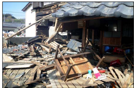
津波で倒壊した住宅（北茨城市）
