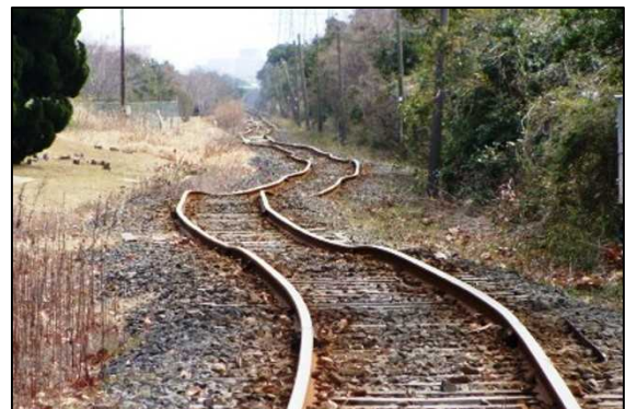
地震で線路が歪んだ大洗鹿島線（鉾田市）
