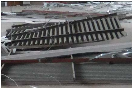
天井が崩落した高等学校体育館（水戸市）
