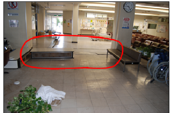
○北茨城市立総合病院（北茨城市） 本震（3/11）、余震（4/9）により地盤沈下を繰り返した
