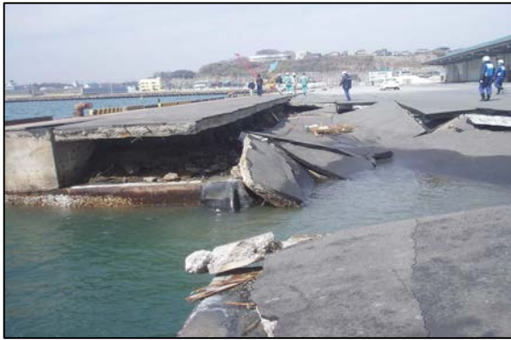
津波で崩壊した茨城港・日立港区の岸壁・埠頭（日立市）
