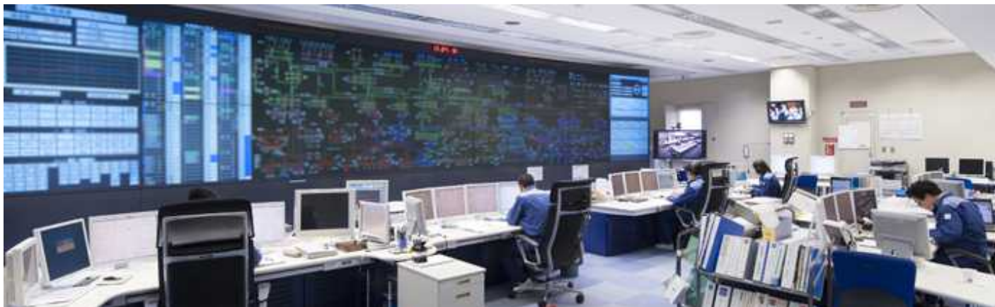
(電力系統を監視・制御する給電制御所)
