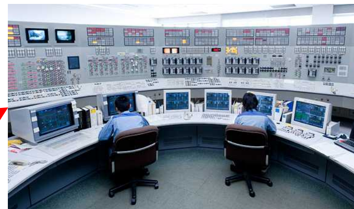
(発電・燃料設備を監視・制御する中央制御室)
