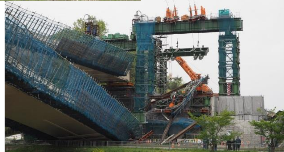
[兵庫県神戸市内で発生した橋梁建設工事における橋桁落下災害の災害調査]
