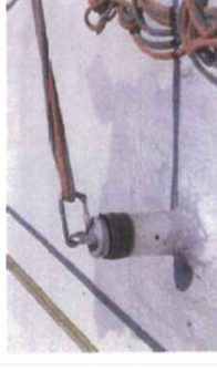
施工時及び維持管理時まで考えて安全帯の取付け金具をあらかじめ構造物に取り付けるよう設計した例
