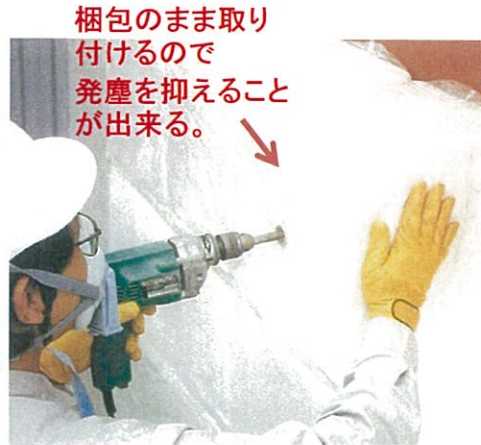
大型加熱炉等での ブロック状での取付 の現場写真
