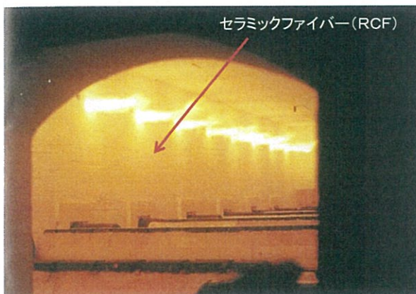
炉内燃焼状況
