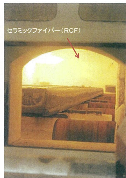
炉内燃焼状況
