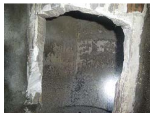
写真Ⅱ-9 ハイスタック煙突断熱材
