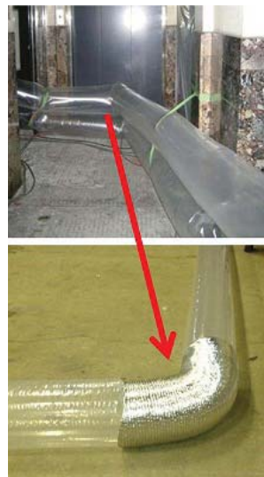
図-9 ビニールダクトの曲がり部分に環状の支え（アルミ製ダクト）を重ねて使用した例
