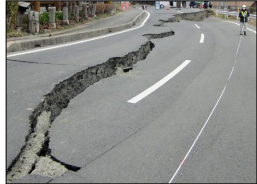
■ 幹線道路（高萩市） 地盤沈下により、大規模な亀裂が入り幹線道路が寸断された。
