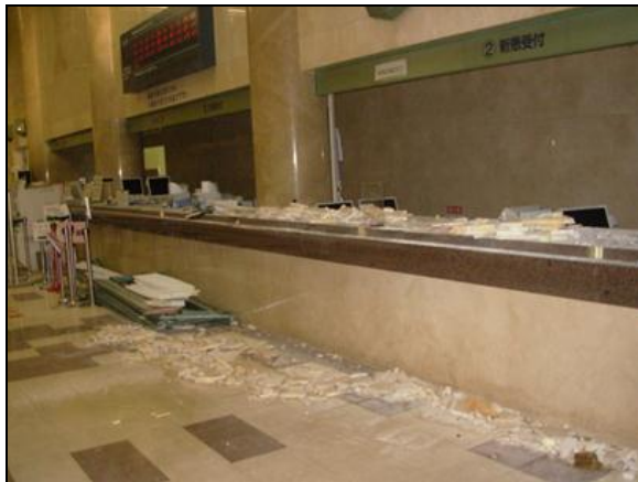
○県立中央病院（笠間市） 待合ホールの壁片が多数落下したほか、病棟、手術室、救急センターなどが損傷、患者全員屋外待避
