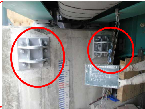
落橋防止装置(橋軸方向)
