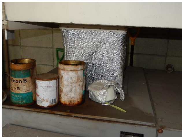
たわみ継手アルミ箔貼り（石綿布）
