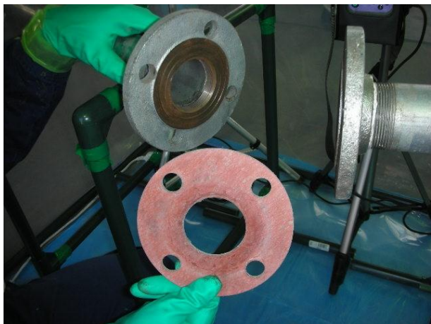
劣化していないガスケット
