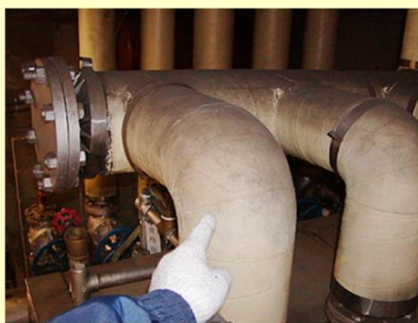
配管エルボ部分の石綿保温材 外観
