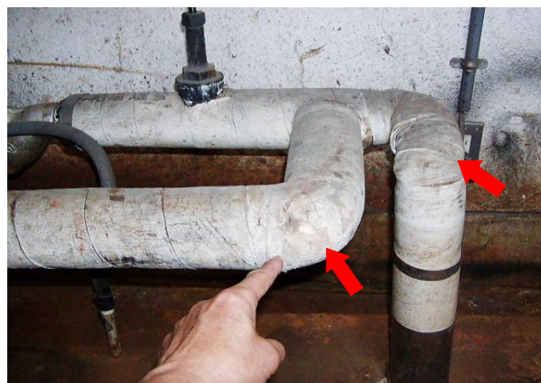
配管エルボを覆う石綿含有保温材
