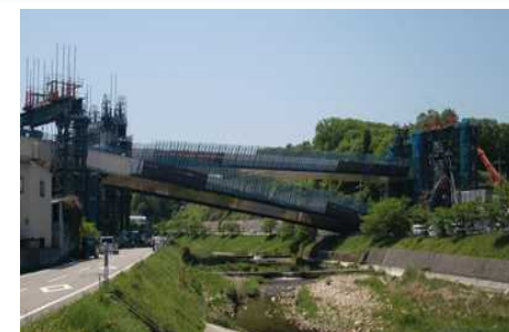
〔兵庫県神戸市内で発生した橋梁建設工事における橋桁落下災害の災害調査〕
