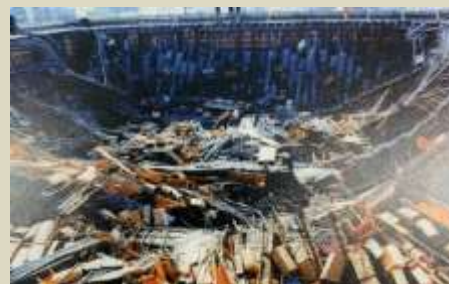
建設現場での天井崩落災害 現地調査風景(参考)
